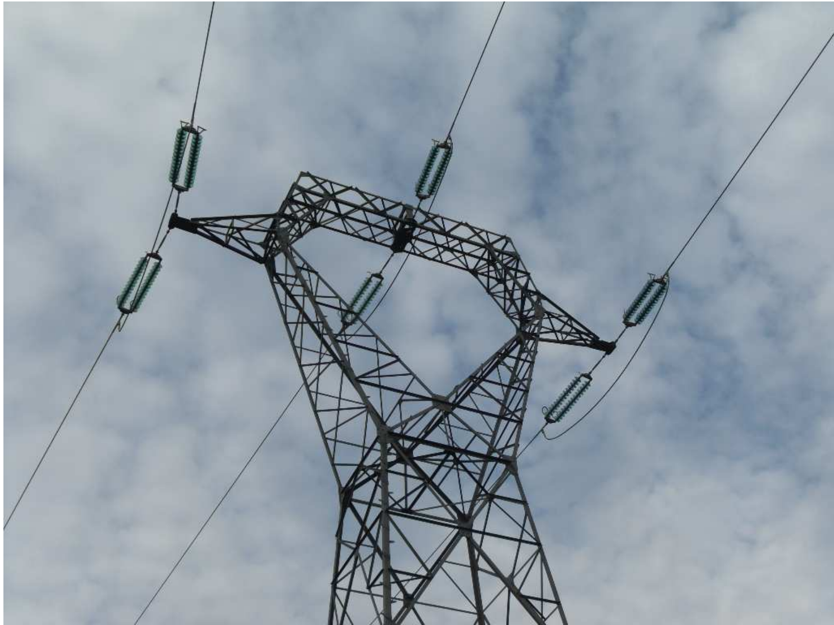
Type de pylône acheminant l'énergie sur la ligne HT 1
